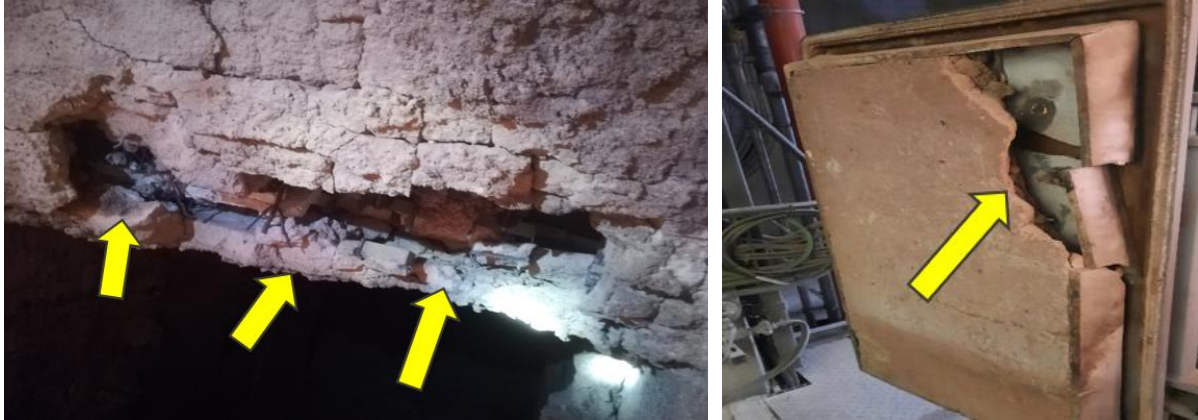
Foto 6: schade aan de vuurvaste bekleding veroorzaakt door explosies
